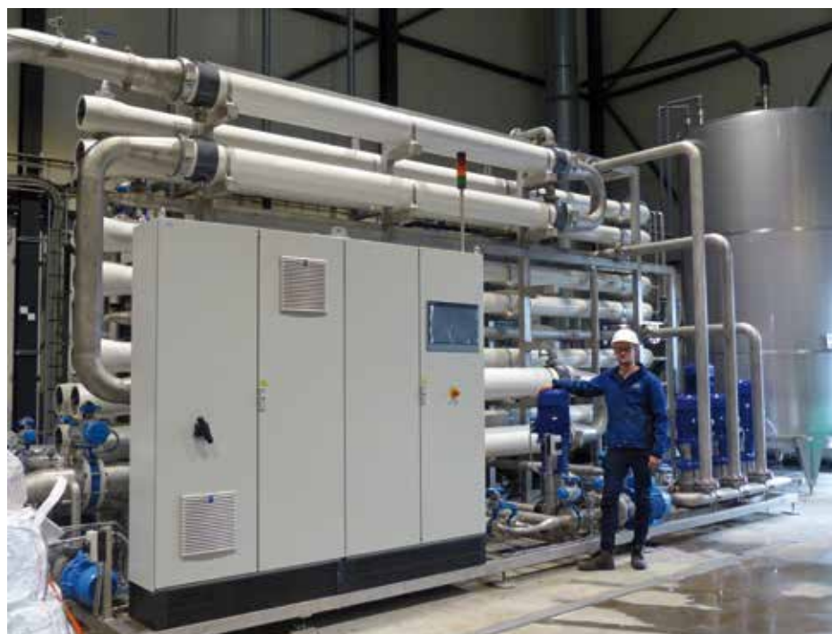
Demonstratie-installatie voor het isoleren en het concentreren van vetzuren. Thomas Roersma, Technical Sales Engineer bij Wafilin licht toe: het concentreren van vetzuren met nanofiltratiemembranen is nog niet eerder op deze schaal toegepast en is daarom vanuit technologisch perspectief uniek. Dit project is mede gefinancierd door het European Regional Development Fund (EFRO).
